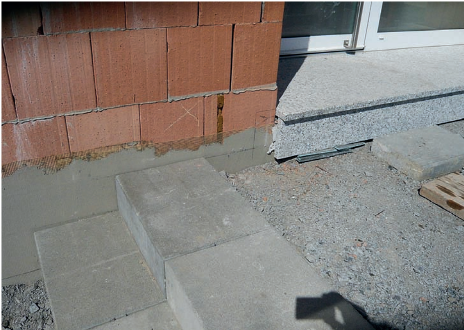
Fehlende Sockelabdichtungen im Neubau.
